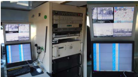
空洞探査車内
